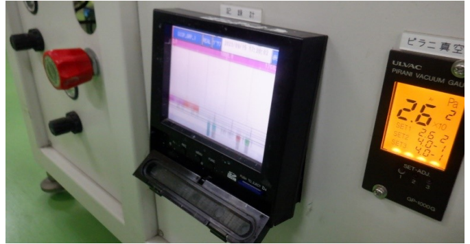
温度記録計:画面が振れている見にくい 取付が浮いている。固定されていない
